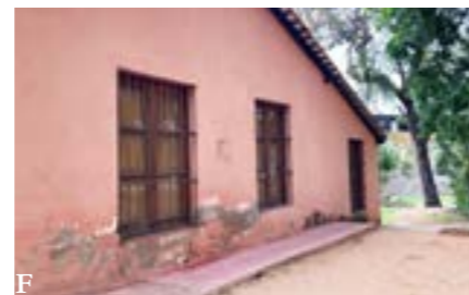
Fig. A. Fachada del Museo. Fig. B. Galería del Museo. Fig. C y F. Estado de deterioro de los muros del museo. Fig. D. Exhibición de Cabriolet. Fig. E. Baño en muy mal estado y muy sucio. Depósitos a los costados.
